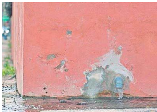
El salidero de aguas de las viviendas de Sotorrebolo.
